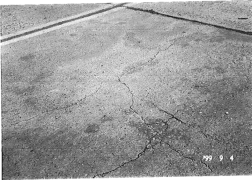
ภาพประกอบ ข.9 รอยแตกแบบสุ่ม (Random Cracking)
