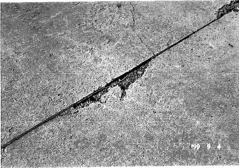
ภาพประกอบ ข.7 รอยเป็นตรงรอยต่อและรอยแตก (Spalling at joints and crack)
