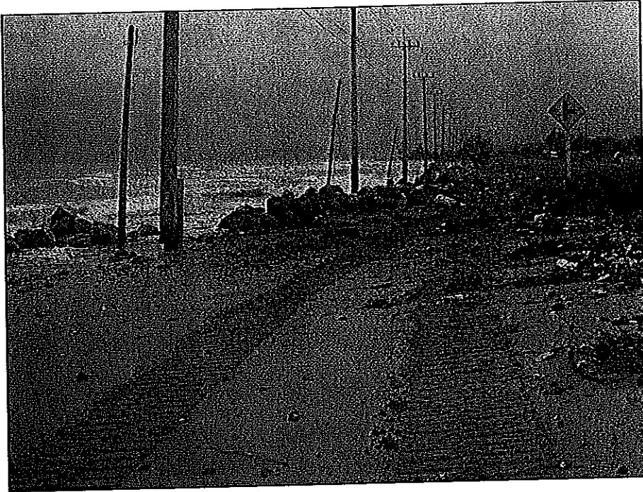
ภาพประกอบ ค-1 สภาพการกัดเซาะบริเวณบ้านเกาะฝ้าย (1) และบ้านเกาะฝ้าย (2)
