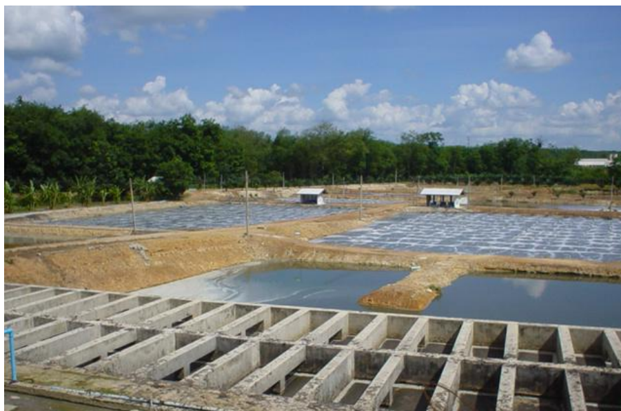
ภาพประกอบที่ 1-10 ตัวอย่างระบบบำบัดน้ำเสียของโรงงานน้ำยางชั้น ที่มา: กรมโรงงานอุตสาหกรรม (2548)
