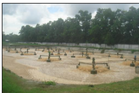
ฎ.ลักษณะบ่อบำบัดเติมอากาศ
