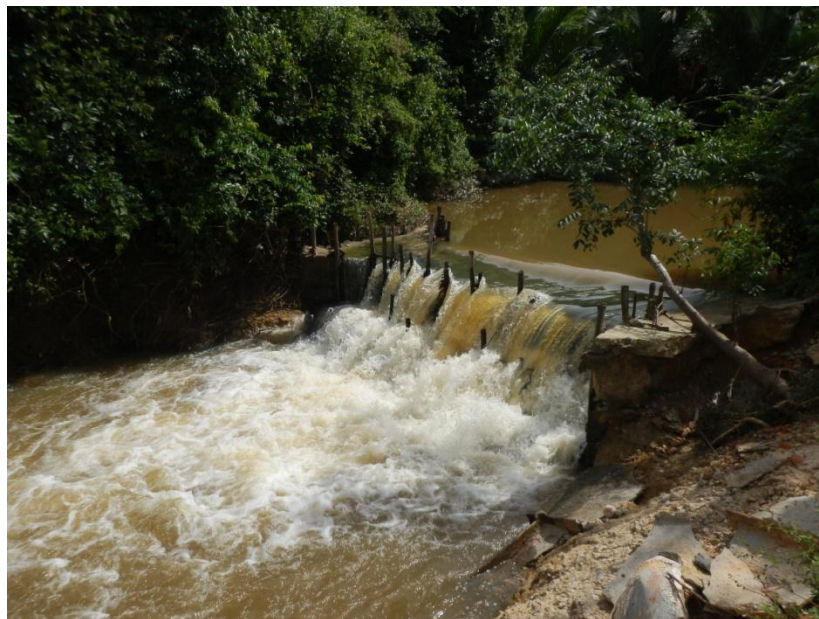
ภาพที่ 20 การพังทลายของฝายกั้นถาวรในหมู่ที่ 2 บ้านทุ่งนนท์ ที่มา : ถ่ายโดย ผู้วิจัย 9 ตุลาคม 2554
