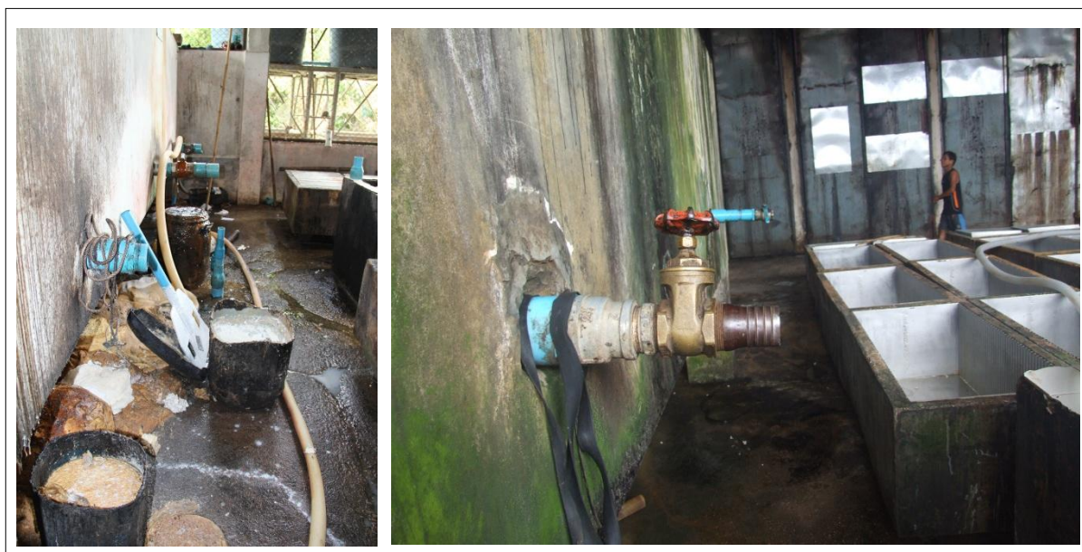
ภาพประกอบที่ 3-40 ภาพซ้ายแสดงท่อที่ไม่มีการติดตั้งวาล์วเปิดปิด และ ภาพขวาแสดงการติดตั้งอุปกรณ์วาล์วเปิดปิด
