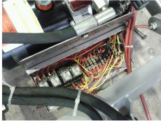
รูปที่ 3.39 ตำแหน่งกล่องควบคุม
