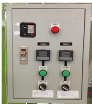
(ก) ชุดควบคุมอุณหภูมิของหม้อหลอม และท่อลำเลียงพอลิเอทิลีนแวกซ์
