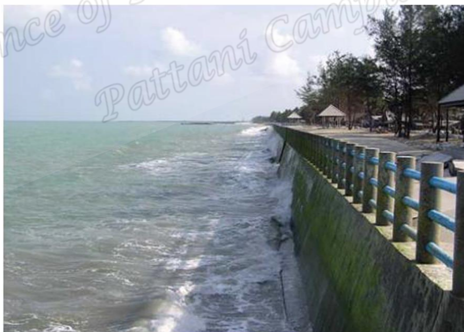
รูปที่ 9 กำแพงกันคลื่นแบบแนวตั้งบริเวณชายฝั่ง บ้านหน้าสตน ต.หน้าสตน อ.หัวไทร จ.นครศรีธรรมราช ที่มา : สำนักงานนโยบาย และแผนทรัพยากรธรรมชาติและสิ่งแวดล้อม (2550)
