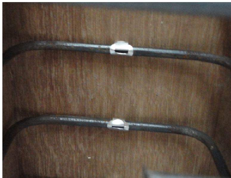
รูปที่ 3.5 การวางเหล็กปลอกในกรณีไม่มีวัสดุเสริมกำลังหลัก
