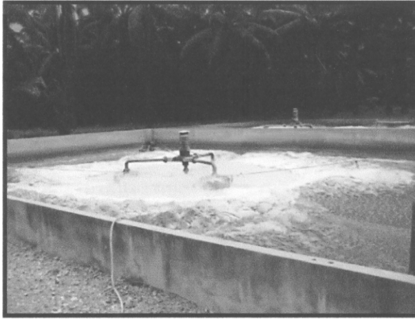
ภาพประกอบที่ 2.1 บ่อเติมอากาศของโรงงาน บ.วงศ์บัณฑิต จำกัด อ. อ่าวลึก จ.กระบี่
