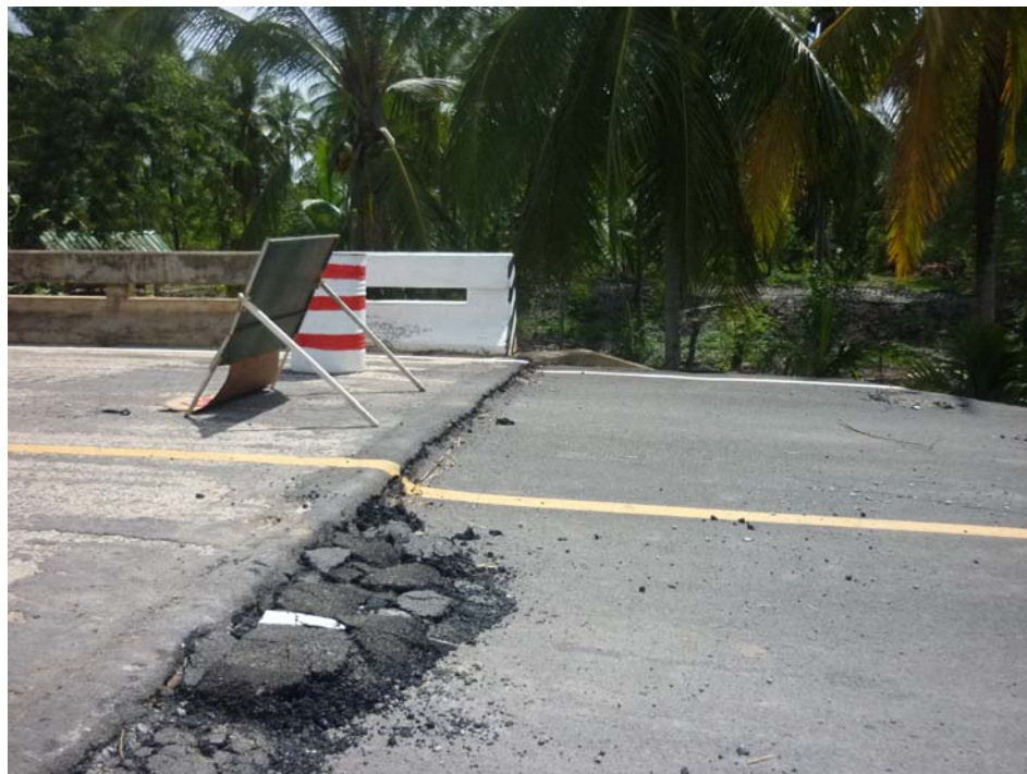
รูปที่ 1.1 การทรุดตัวของถนนบนชั้นดินเหนียวอ่อน
