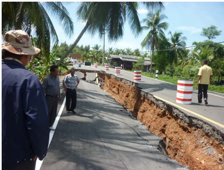
รูปที่ 1.2 การวิบัติของถนนบนชั้นดินเหนียวอ่อน
