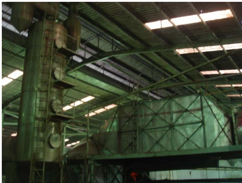
ภาพประกอบ 3-3 แสดงหอดูดซึมแบบเป็ยกในแนวนอน (Cross flow absorber) ที่ใช้ในการบำบัดกลิ่นจากก๊าซเสียที่ปล่อยออกจากเตาอบยาง บริษัท สยามอินโด รับเบอร์ จำกัด
