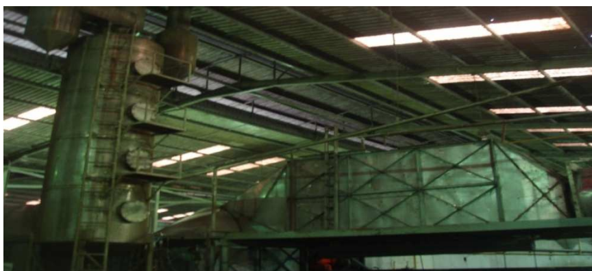
ภาพประกอบ 4-28 แสดงหอดูดซึมแบบเปียกในแนวนอน (Cross flow absorber) ที่ใช้ในการบำบัดกลิ่นจากก๊าซเสียที่ปล่อยออกจากเตาอบยาง บริษัท สยามอินโดรับเบอร์ จำกัด
