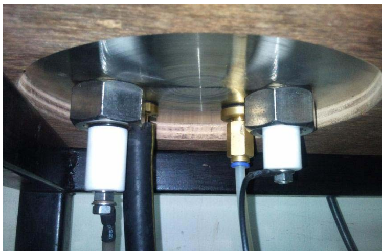
ภาพประกอบที่ 8 การต่อแหล่งจ่ายไฟฟ้าแรงดันสูง และแก๊สเข้าสู่ระบบ
