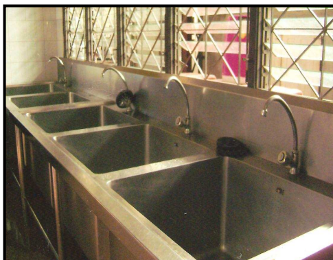
ภาพประกอบ 10 อ่างล้างภาชนะอุปกรณ์
