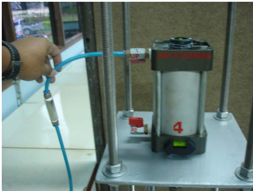
ภาพประกอบที่ ก-13 แสดงภาพการต่อสายสีฟ้าอุปกรณ์กันการไหลย้อนเข้าสู่ Air cylinder ที่วาล์วทางด้านบน (UP)
