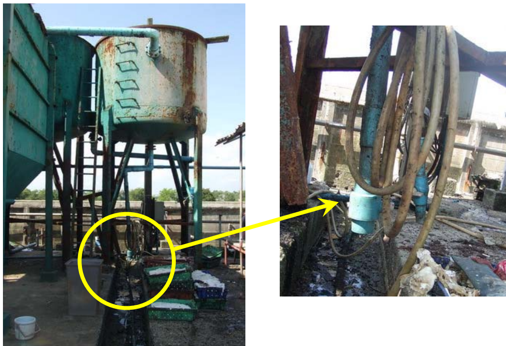
ภาพประกอบ 2-1 ถังเก็บรวบรวมน้ำเสีย (storage tank) และจุดเก็บตัวอย่างน้ำเสีย
