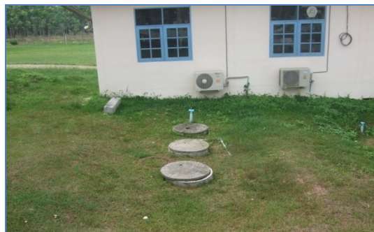
ระบบบำบัดอาคารผู้ป่วยนอก 1 (รพ. ค)
