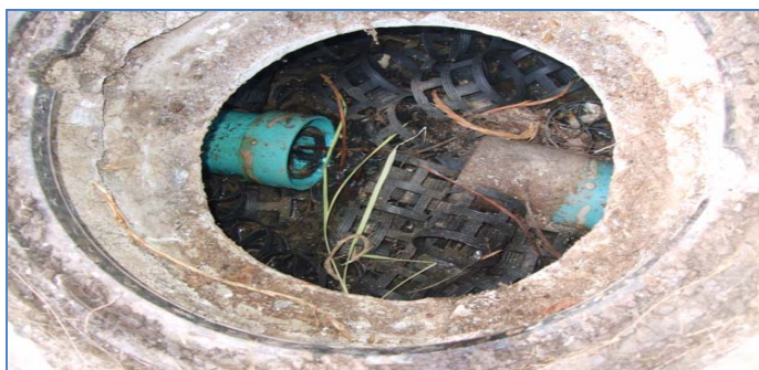
ภาพที่ 3-17 ถังกรองไร้อากาศ
