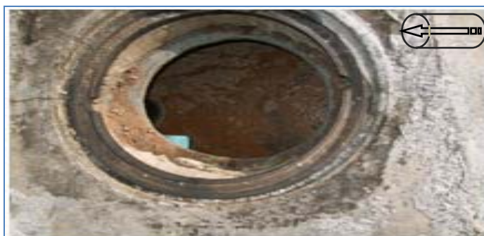
ภาพที่ 3-8 บ่อดักไขมัน
