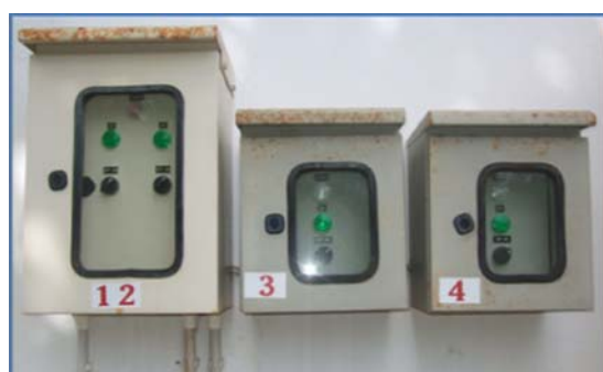
แผงควบคุมไฟฟ้า
