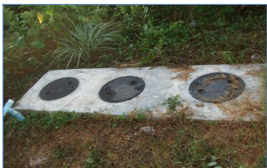
ระบบบำบัดอาคารโรงครัว (รพ. ข)
