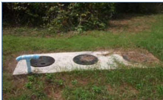
ระบบบำบัดอาคารผู้ป่วยนอก 1 (รพ. ข)
