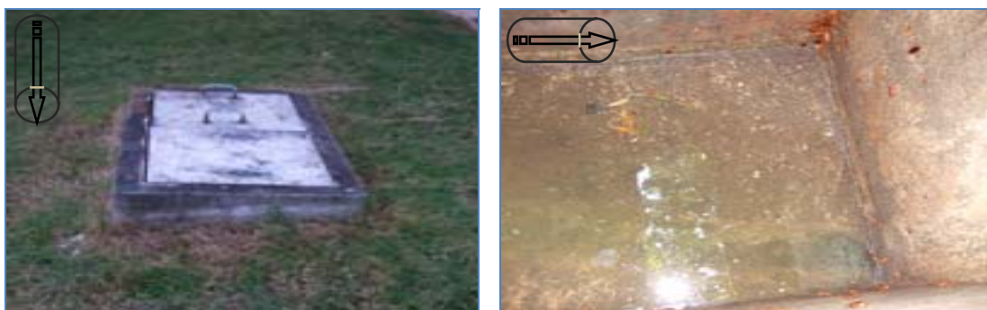
ภาพที่ 3-6 บ่อพักน้ำเสีย
