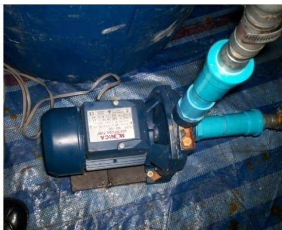
รูปที่ 3.10 ปั๊มน้ำหล่อเย็น
