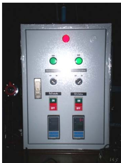
รูปที่ 3.8 รูปแผงควบคุมวงจรไฟฟ้า
