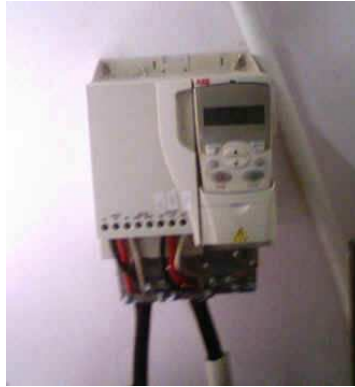
รูปที่ 4.14 เครื่องควบคุมความถี่ไฟฟ้ากระแสสลับ
