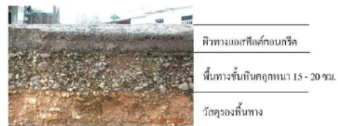
ภาพที่ 4 ลักษณะโครงสร้างชั้นทางแอสฟัลต์คอนกรีต
