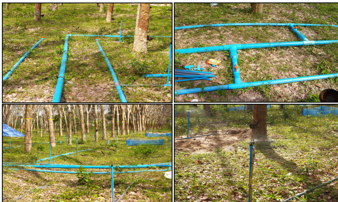
ภาคผนวกภาพที่ 4 การติดตั้งระบบน้ำในแปลงทดลองที่มีการให้น้ำแก่ต้นยางพารา ได้แก่ ท่อส่งน้ำ วาล์วเปิดปิดน้ำ และมินิสปริงเกอร์ รัศมี 2 เมตร
