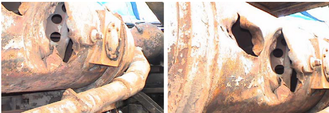
ตำแหน่งถังน้ำมัน ที่มีท่อไอเสียพาดผ่าน
