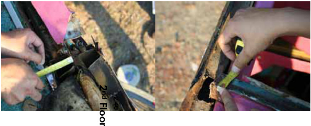
เหล็กโครงสร้างรับหลังคา
