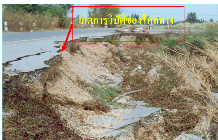
ค) ถนนสายหลังโรงพยาบาลสงขลา ปี 2549 เกิดการวิบัติแบบเสถียรภาพความลาด
