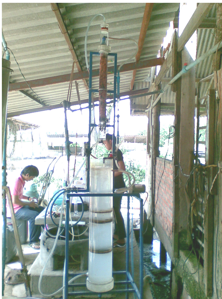
ภาพประกอบที่ 3-8 แสดงชุดการทดลองของคอลัมน์บรรจุที่ใช้สำหรับบำบัดแก๊สชีวภาพ ติดตั้งที่ มงคลฟาร์ม อ. กวนขุน จ. พัทลุง
