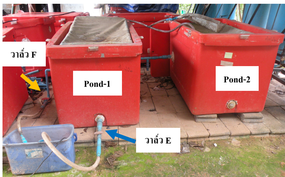
หมายเหตุ : E คือ วาล์วปรับอัตราการไหล และ F คือ วาล์วควบคุมการสูบน้ำเสียย้อนกลับ ภาพประกอบ 2-7 ลักษณะของระบบบ่อบำบัดย่อยประยุกต์ที่ติดตั้ง ณ สหกรณ์โรงอบ/รมยาง ยูงทอง
