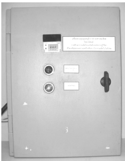
ภาพประกอบที่ 7 ตู้ควบคุมอุณหภูมิ
