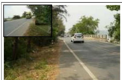
รูปที่ 18 ไม่มีราวกันอันตรายบริเวณสะพาน/ทางโค้ง และท่อระบายน้ำ หากรถเสียหลักอาจทำให้พลัดตกไปได้
