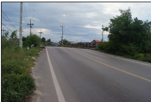
รูปที่ 4-31 ไม่มีราวกันอันตรายบริเวณสะพาน อาจเสี่ยงต่อการเกิดอุบัติเหตุรุนแรง
