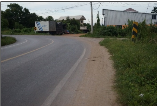
รูปที่ 4-29 ไม่มีราวกันอันตรายบริเวณทางโค้ง อีกทั้งยังมีทางเข้า-ออกของโรงงาน และมีฝุ่นทรายบนผิวจราจร
