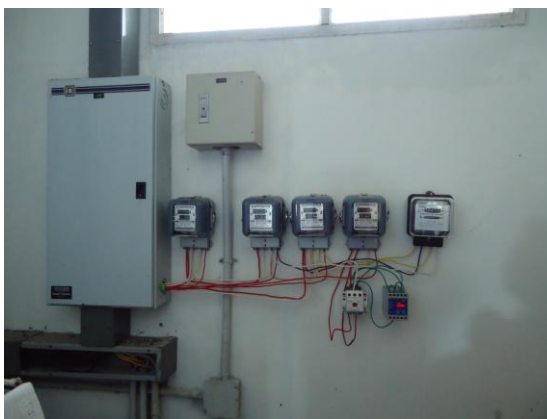
(ก) การติดตั้งมิเตอร์วัดไฟฟ้าทั้ง 5 ห้องทดลอง
