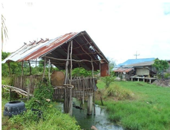
ภาพที่ 50 การนำไม้เสมีตมาซ่อมแซมคอกหมู ที่มา: ถ่ายภาพโดยผู้วิจัย วันที่ 7 ตุลาคม 2556
