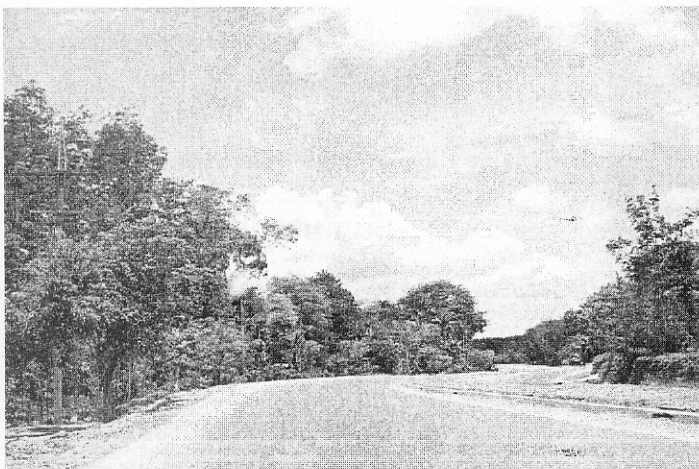
รูปที่ 2.5 : ถนนที่เปิดใช้งานแล้ว แต่ยังคงขาดป้ายชี้้นำทาง และเส้นแบ่งช่องจราจรและเส้นขอบทาง
