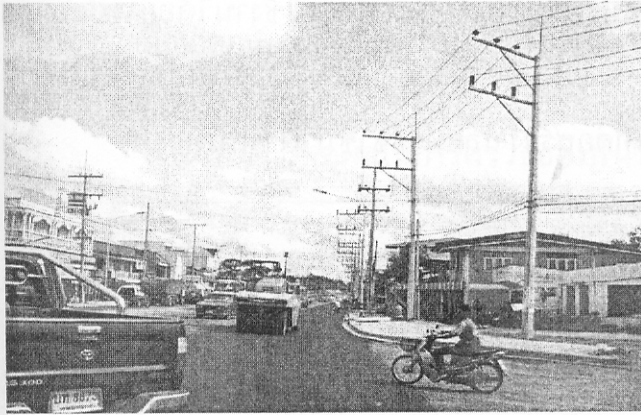
รูปที่ 2.2 : การขาดการจัดการจราจรระหว่างเครื่องจักรก่อสร้างกับการจราจรปกติเพิ่มโอกาสในการชน
