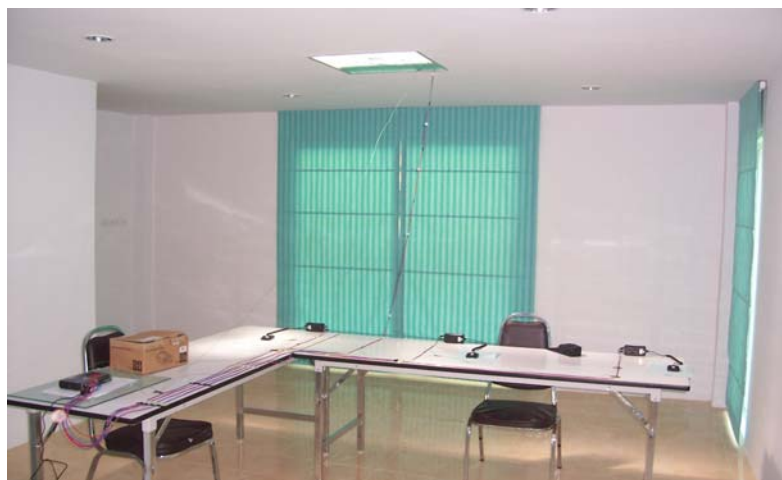
รูปที่ 5.2 ความส่องสว่างของห้องวิจัยหลังติดตั้งระบบท่อนำแสงภายในอาคาร
