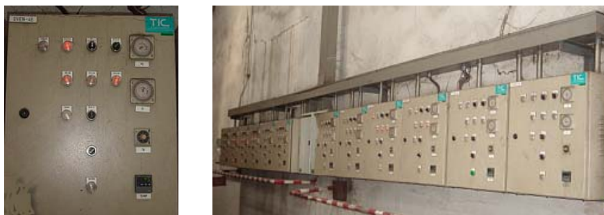
ภาพประกอบที่ 3.8 ตู้ควบคุมการทำงานอัตโนมัติ
