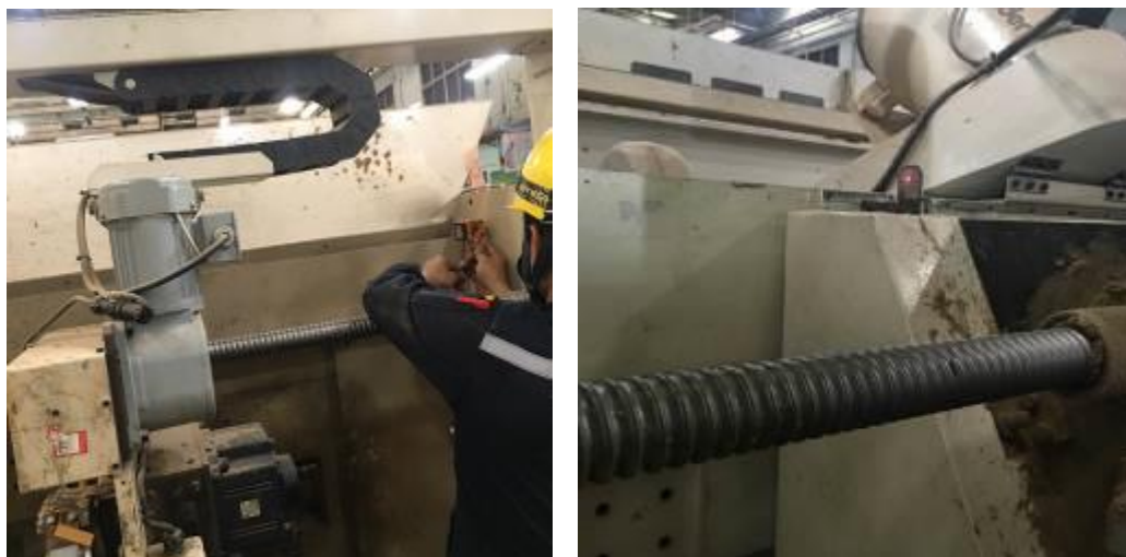
รูปที่ 4.2 การติดตั้งอุปกรณ์เซ็นเซอร์ (Sensor) ที่ใช้วัดระยะตำแหน่งของชุด Paper guide ที่เฟรมรางพับ
