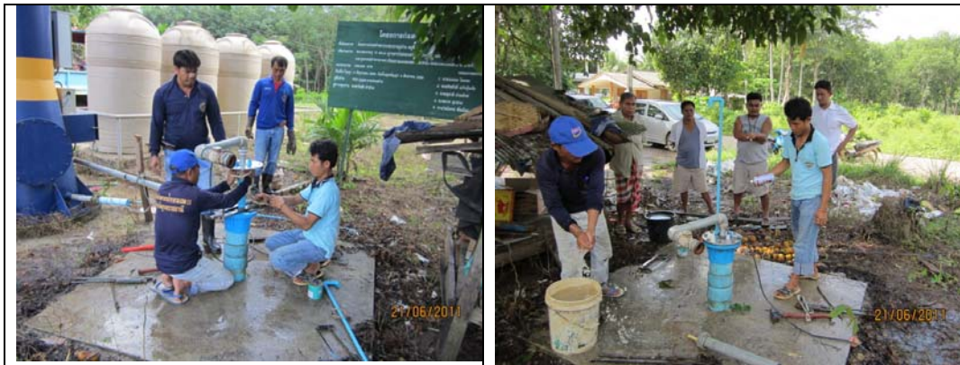
รูปที่ 3-11 แสดงการติดตั้งอุปกรณ์ป้องกันน้ำท่วมบ่อน้ำบาดาลอย่างถาวร
