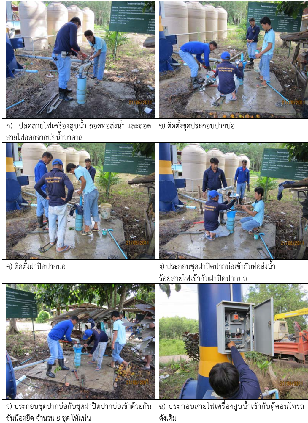
รูปที่ 4-6 การติดตั้งอุปกรณ์ป้องกันน้ำท่วมบ่อน้ำบาดาลอย่างถาวรของบ่อใหม่ (บ้านวังยาว หมู่ที่ 14 ตำบลนาไม้ไผ่ อำเภอทุ่งสง จังหวัดนครศรีธรรมราช)
