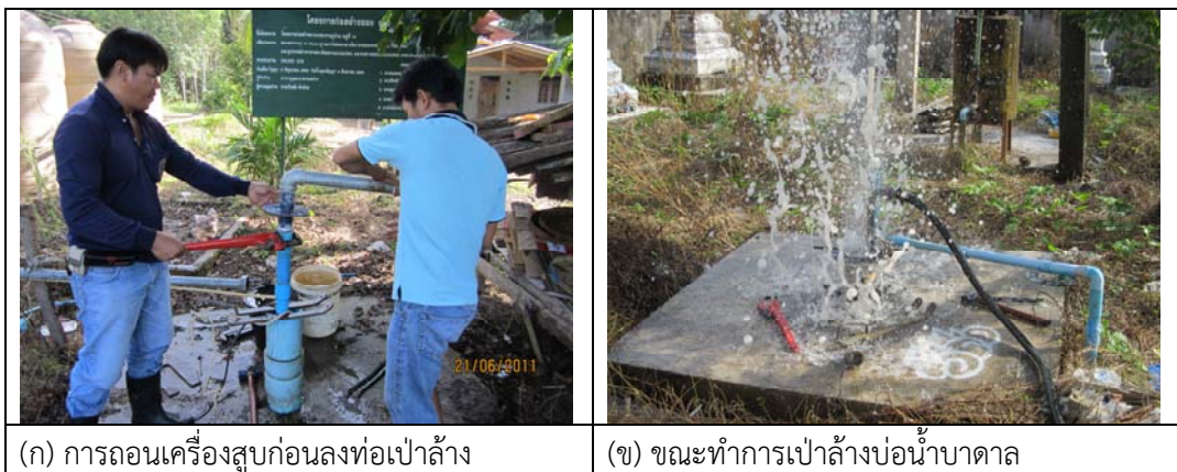
รูปที่ 3-2 แสดงขั้นตอนการถอนเครื่องสูบน้ำก่อนลงท่อเป่าล้าง และขณะทำการเป่าล้าง
