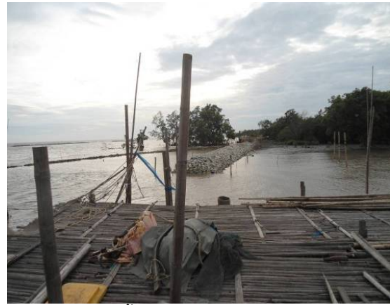
(ข) บริเวณที่ตั้งของเขื่อนป้องกันคลื่นนอกชายฝั่ง ด้านทิศตะวันตก
