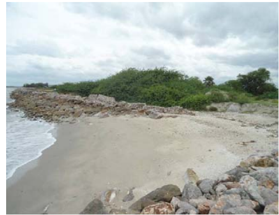
(ง) ปัจจุบันมีการกัดเซาะชายฝั่งบริเวณทิวศไต้ของ เขื่อนกันทรายและคลื่นปากคลองบางกุกุฬา
