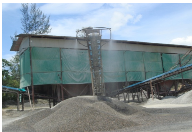
ภาพประกอบ 11 แสดงการสร้างอาคารปิดคลุม 3 ด้าน
